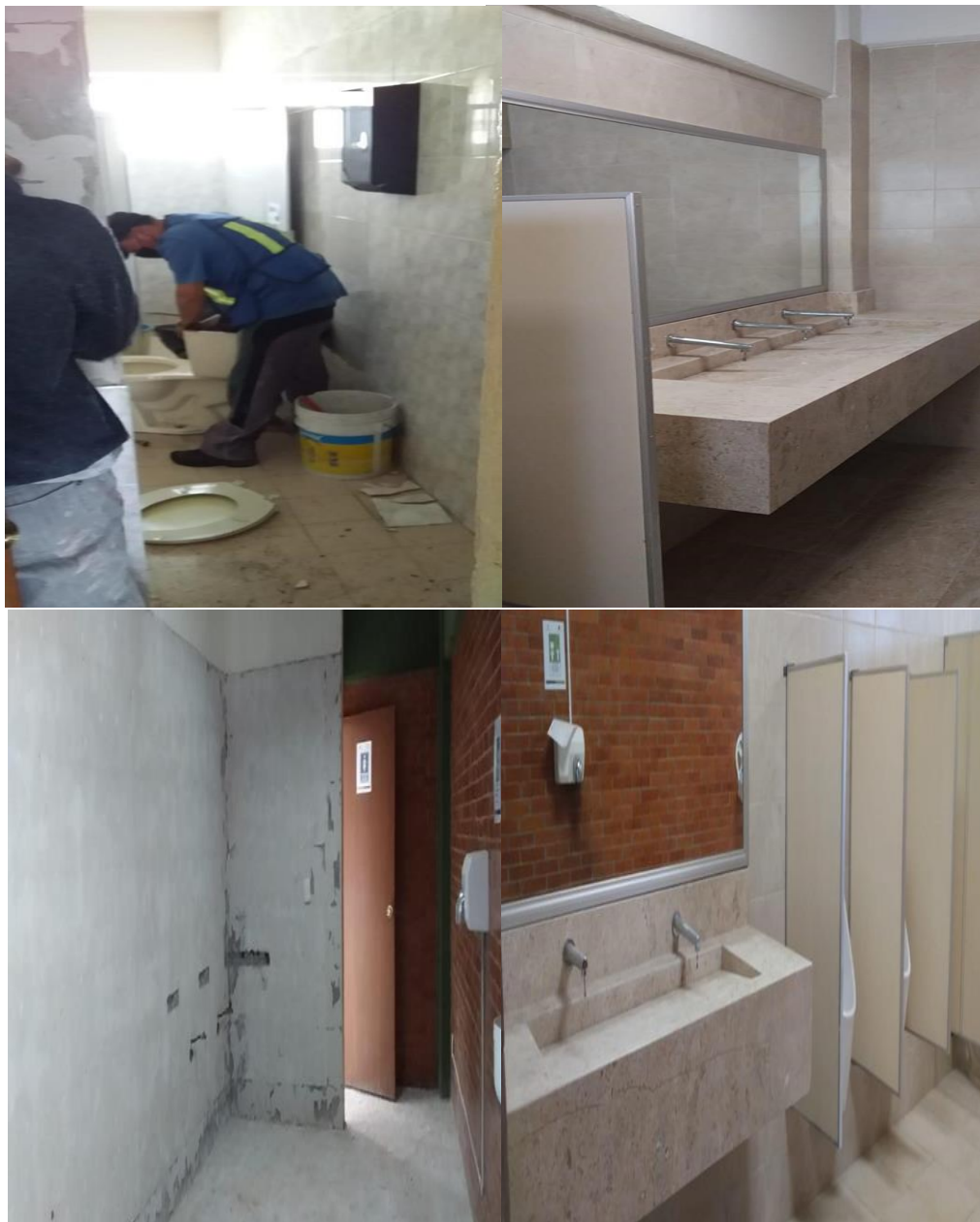
Fotografía No. 24. Colocación de persianas y remodelación de sanitarios del C.U. Amecameca
